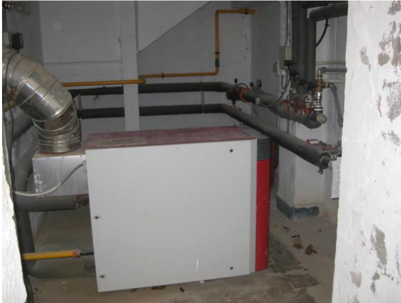
Imagen 23: Casa de Cultura. Sala de calderas
