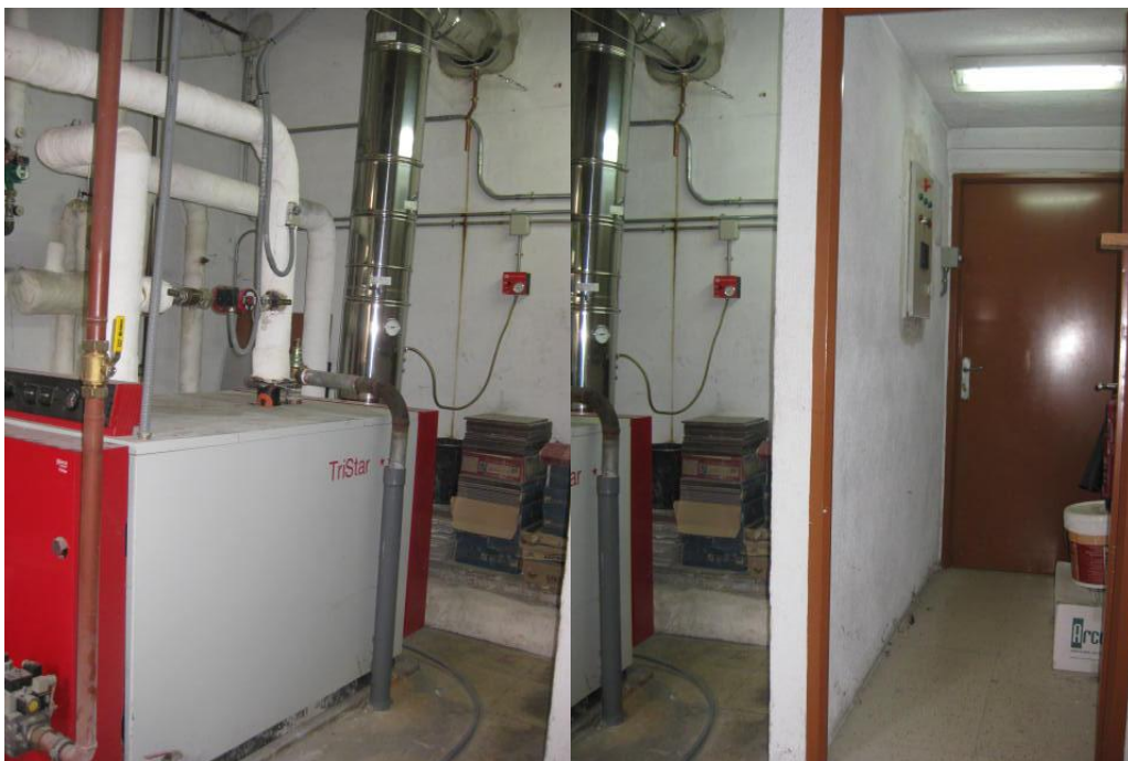
Imagen 22: Colegio CEIP Araia. Sala de calderas
