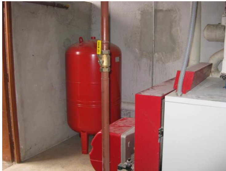
Imagen 8: Deposito de expansión en sala de calderas
