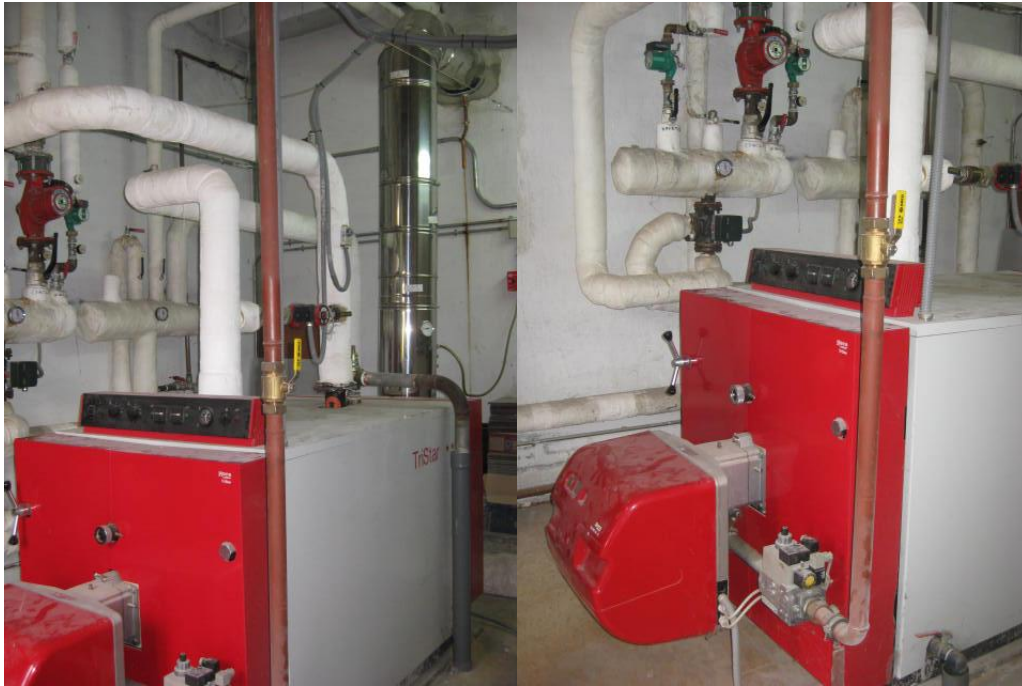
Imagen 21: Colegio CEIP Araia. Sala de calderas
