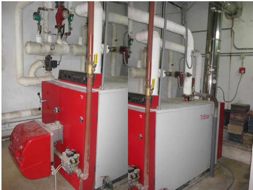
Imagen 6: Sala de calderas colegio
