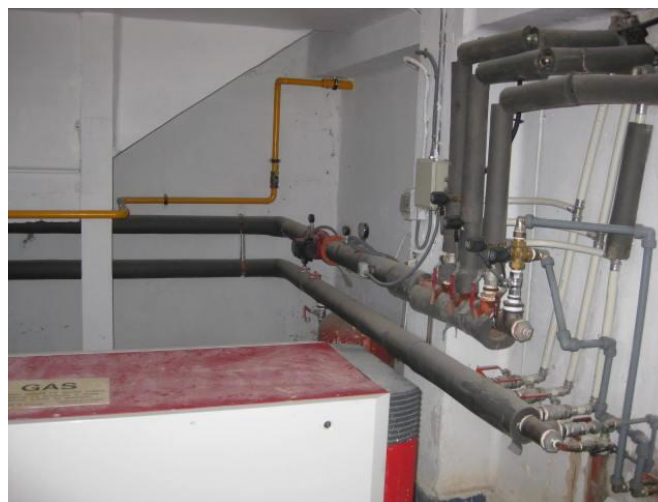
Imagen 24: Casa de Cultura. Sala de calderas
