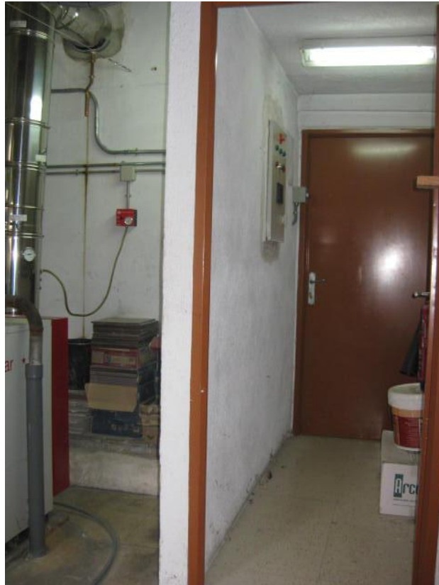
Imagen 7: Ubicación cuadro eléctrico sala de calderas
