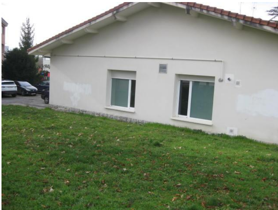
Imagen 20: Centro de salud. Fachada Noroeste. Acometida gas
