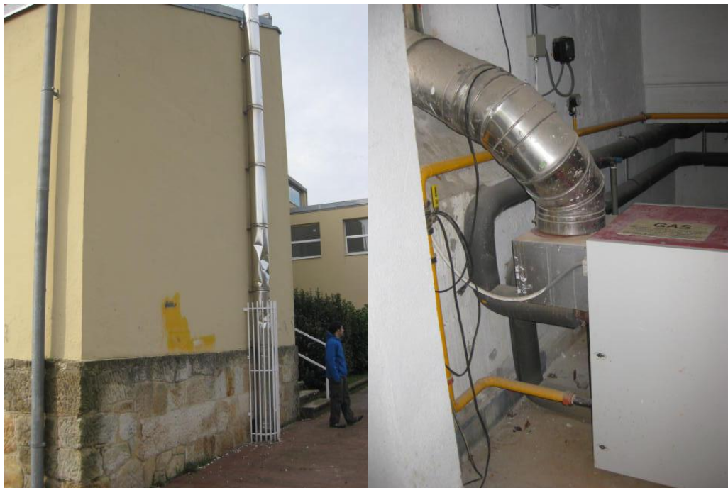
Imagen 12: Salida chimenea sala de calderas
