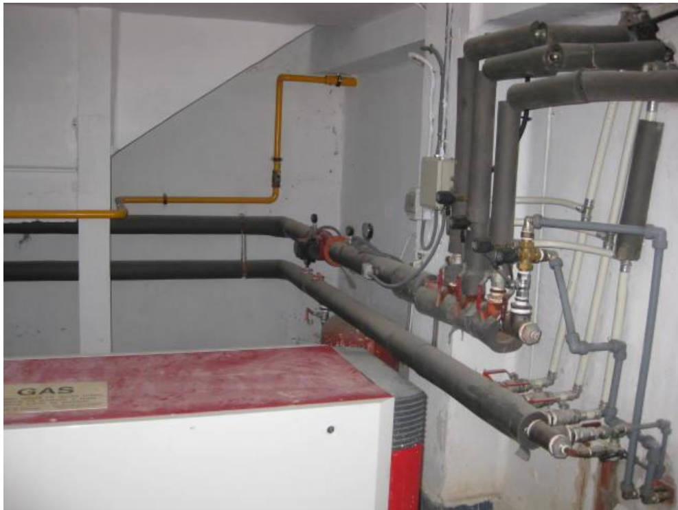
Imagen 14: Circuitos instalación de calefacción Casa Cultura
