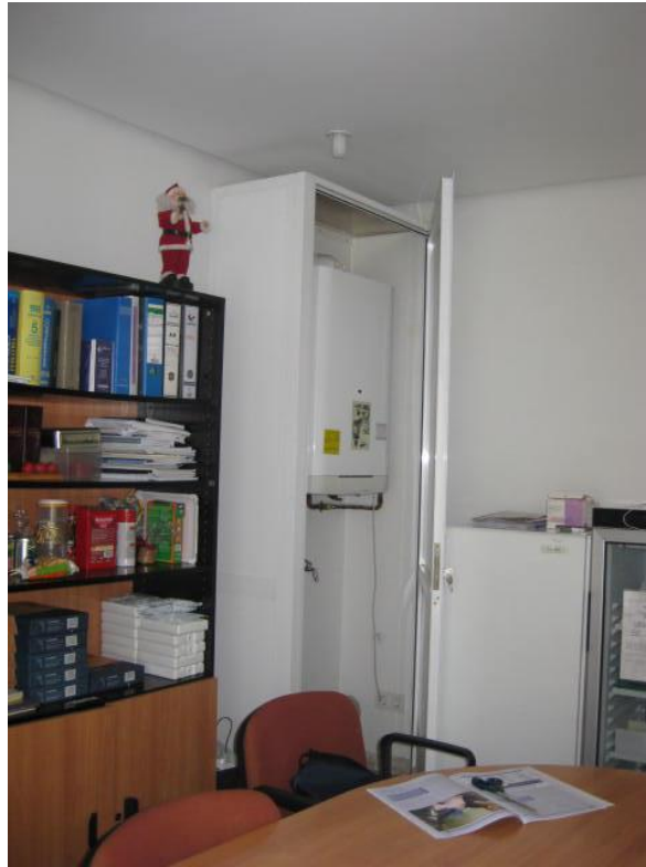
Imagen 17: Ubicación de la caldera en el Centro de salud
